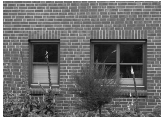
Bild 4. Bei dem überwiegenden Teil der bestehenden Gebäude mit zweischaligen Außenwänden in Norddeutschland findet man keine Lüftungs- oder Entwässerungsöffnungen in der Verblendschale
