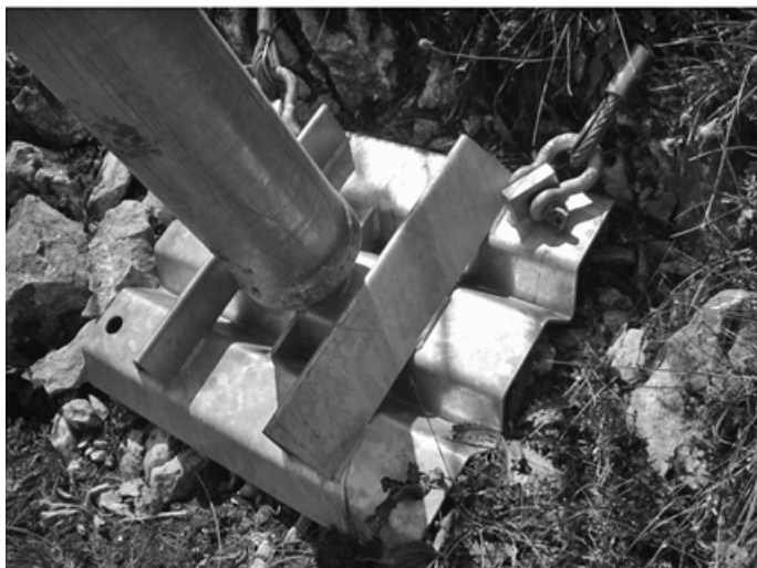
Bild 7-18 (Fortsetzung) Verankerung von Lawinennetzen: (b): Grundplatte einer Gelenksstütze für ein Lawinennetz (Die Stütze ist mit der Platte über eine splintgesicherte Bolzenverbindung verbunden. Die Platte sitzt ohne Verankerung am Boden auf und ist bergwärts durch Seile abgespannt.) (© Rudolf-Miklau)
