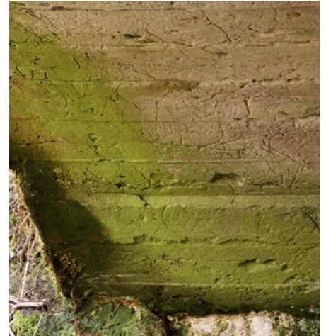
Bild 3.20 Spuren des auf der Brettschalung ausgebreiteten „Makulaturpapiers“ an der ersten „Beton“-Brücke Bernhard Liebolds in Vorwohle
