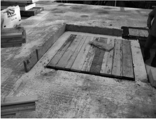
Bild 20. Unvollständige Zweischaligkeit einer Aufzugsschachtkonstruktion, das Treppenpodest liegt auf der inneren Schale auf
