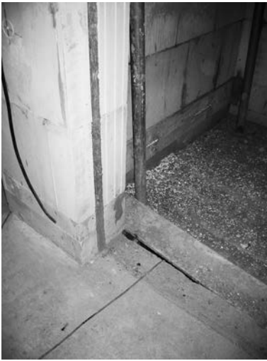
Bild 21. Unvollständige Zweischaligkeit, weil das Treppenhauptpodest mit der Geschossdecke über den Wohnungen verbunden ist
