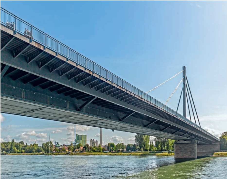
3 Ansicht der Brücke vom Widerlager Pfalz, Seite Wörth 4 Querträger, Fahrbahnsteifen und Ort der Risse
