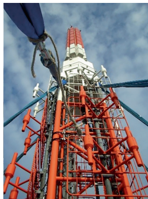
Bild 4. Infolge Wirbelablösung am Antennenaufsatz durchgerissener Eckstiel eines Antennenturms in Fachwerkbauweise (Foto: M. Clöbes)
