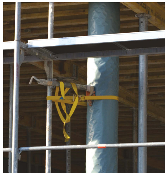
Bild 10. Unzulässige Sicherung eines Fassadengerüsts mittels Spanngurt zur Ladungssicherung (Foto: Küenzlen)
