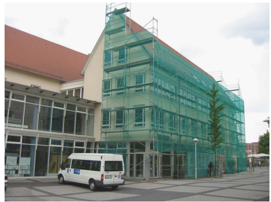
Bild 9. Fassadengerüst mit engmaschigem Netz (Foto: Küenzlen)
