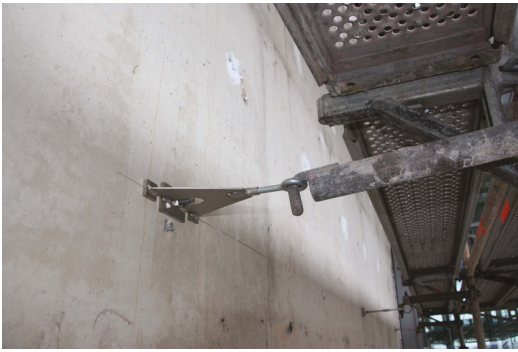
Bild 8. Dauerhafte Einrichtung zur Verankerung von Fassadengerüsten mit Gerüsthalter (Foto: Jakubeit)
