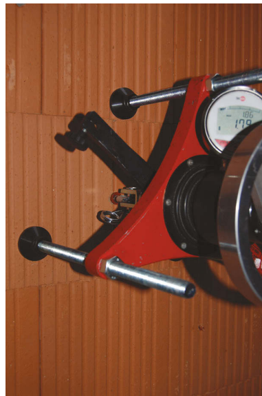
Bild 11. Prüfgerät zur Prüfung eines Kunststoffdübels mit Ringöschraube direkt am Bauwerk (Foto: Würth)
