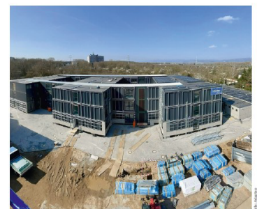
Bild 2 Auf dieser Baustelle entsteht aus hochwertigen Hybridmodulen das Interimsgebäude des Gymnasiums Mainz-Mombach
